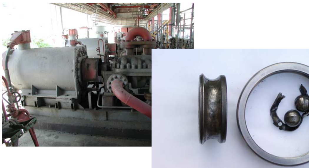
Obr. 6 Poškodenie ložiska od termálnej dilatácie potrubia
